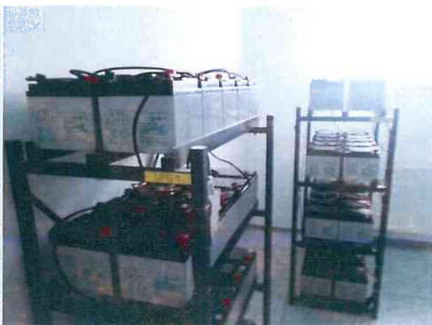
Pomieszczenie z akumulatorami
