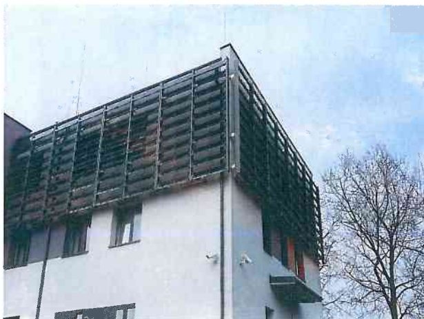
Urządzenia fotowoltaiczne na fasadzie budynku
