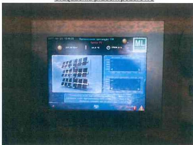
Panel sterowania budynkiem
